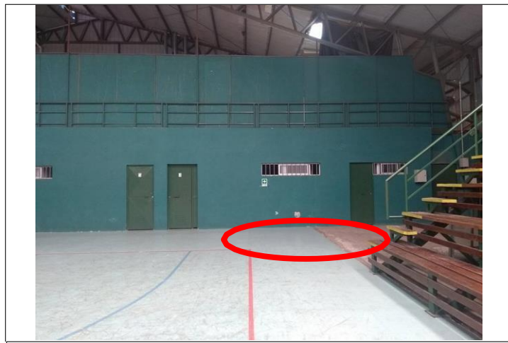
Foto N°1. Costado del gimnasio (cerca de salida de emergencia)
